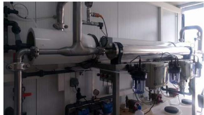
Figura 4. Planta piloto de tratamiento para el agua de rechazo de una fábrica de sílice en Zaragoza, para la recuperación de energía, sulfato de sodio y álcalis
