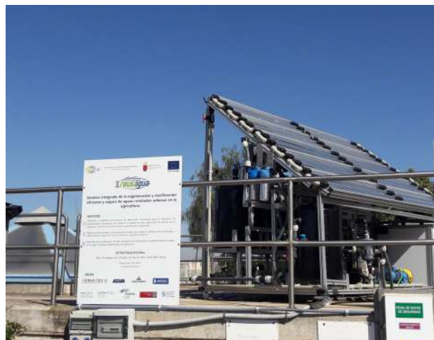
Imagen 1. Planta de reutilización aguas residuales. Fotocatálisis Proyecto REUSAGUA.
